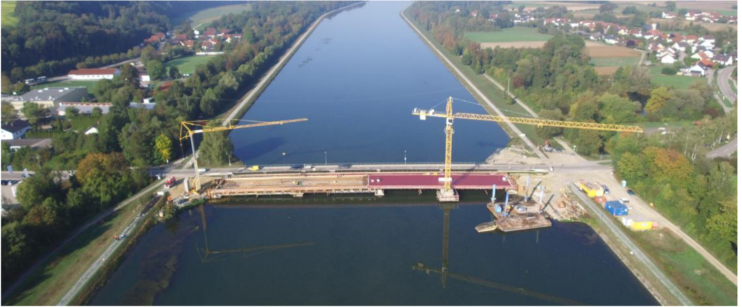
Der Abschnitt 1 des Überbaus ist bereits fertig, während im Abschnitt 2 (Seite Niederviehbach) noch Schalung und Bewehrung erfolgen.
