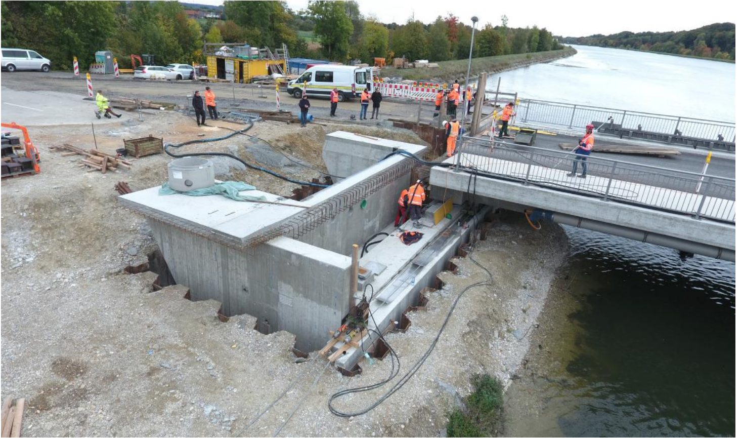
Stück für Stück wurde der rund 3.000 Tonnen schwere Koloss aus Beton und Stahl verschoben.
