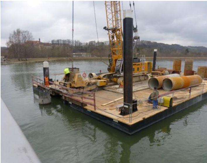
Herstellung der Pfähle für die künftigen Pfeiler von einem Schwimmponton aus, das extra aus den Niederlanden kam.
