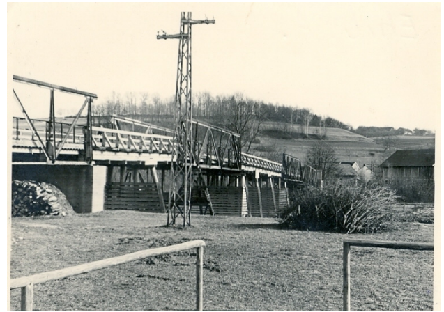
Notdürftig reparierte Brücke
